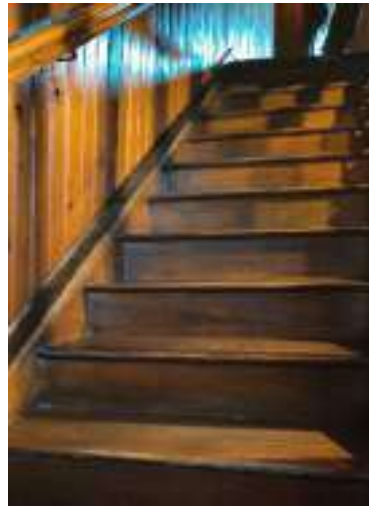
un escalier à changer
